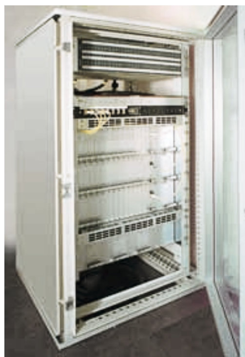
Kopfstation im alten Gebäude
